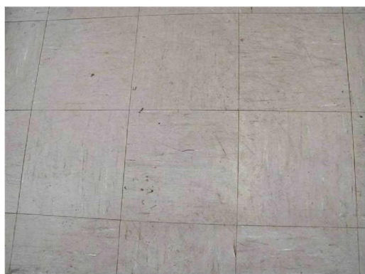
Rys. 8 Płyta podłogowa azbestowa
