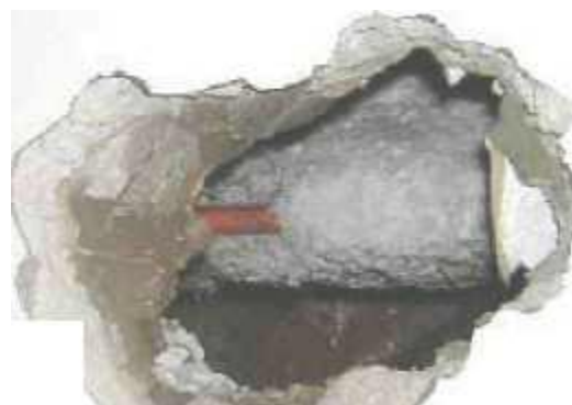
Rys. 7 Azbestowa izolacja rury
